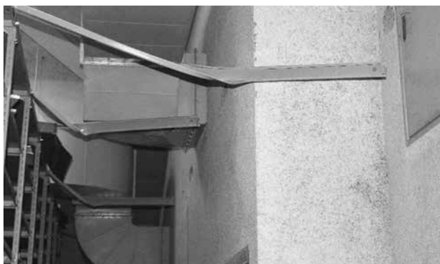
収蔵棚固定金具損壊
