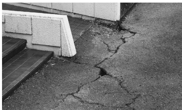
玄関前アスファルト亀裂
