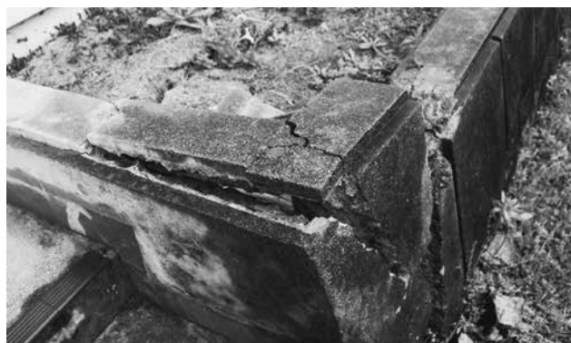
東側通用口亀裂
