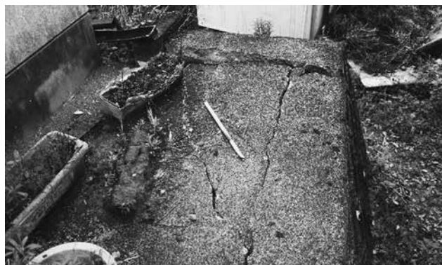
屋外便所東コンクリート亀裂
