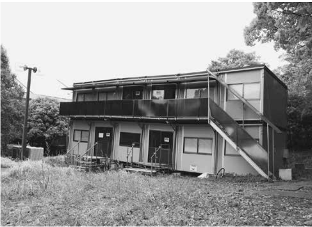
写真1 傾いた現場事務所
